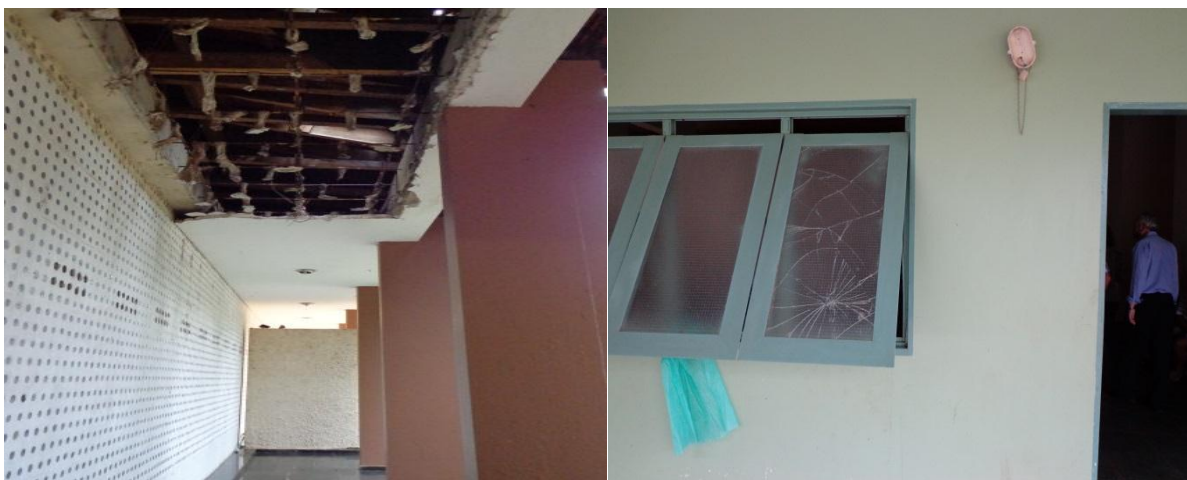
Forro caindo e vidraças quebradas no ISM
