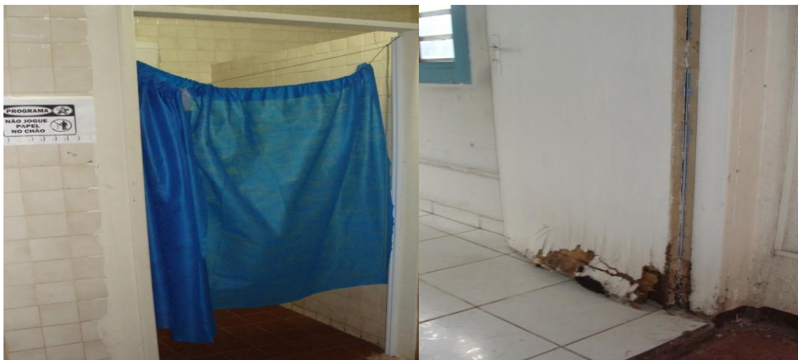
Banheiro sem porta e porta corroída no CAPS ad Guará.
