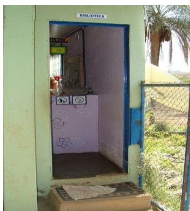
a) Degrau na entrada da biblioteca
