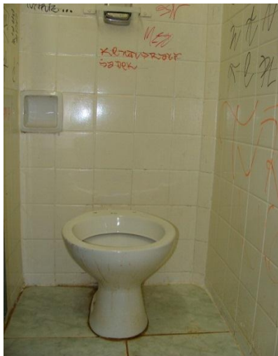
a) Pichações nos sanitários do CEM 417 – Santa Maria
