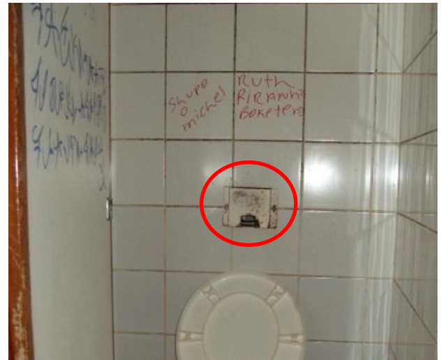
b) Além das pichações, dispositivo anti-furto das válvulas de descarga no CEMEIT - Taguatinga
