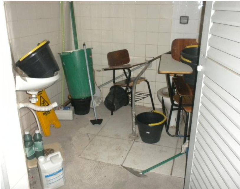
Figura 9 – Sanitário de deficientes - CEM Elefante Branco.
