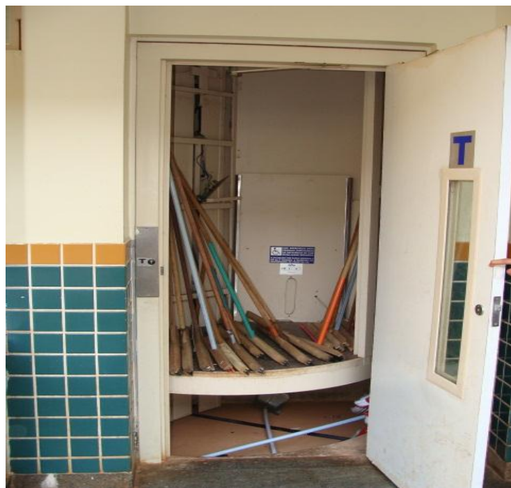
Figura 8 – Elevador de deficientes - CED Pompílio Marques de Souza - Planaltina.
